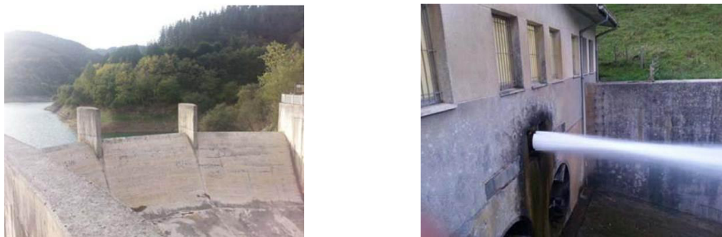
Figura 10.- Órganos de desagüe de la presa de Ibaieder
